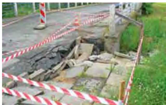
Wyrwa na Solskiego. Tu trzeba zachować szczególną ostrożność.
