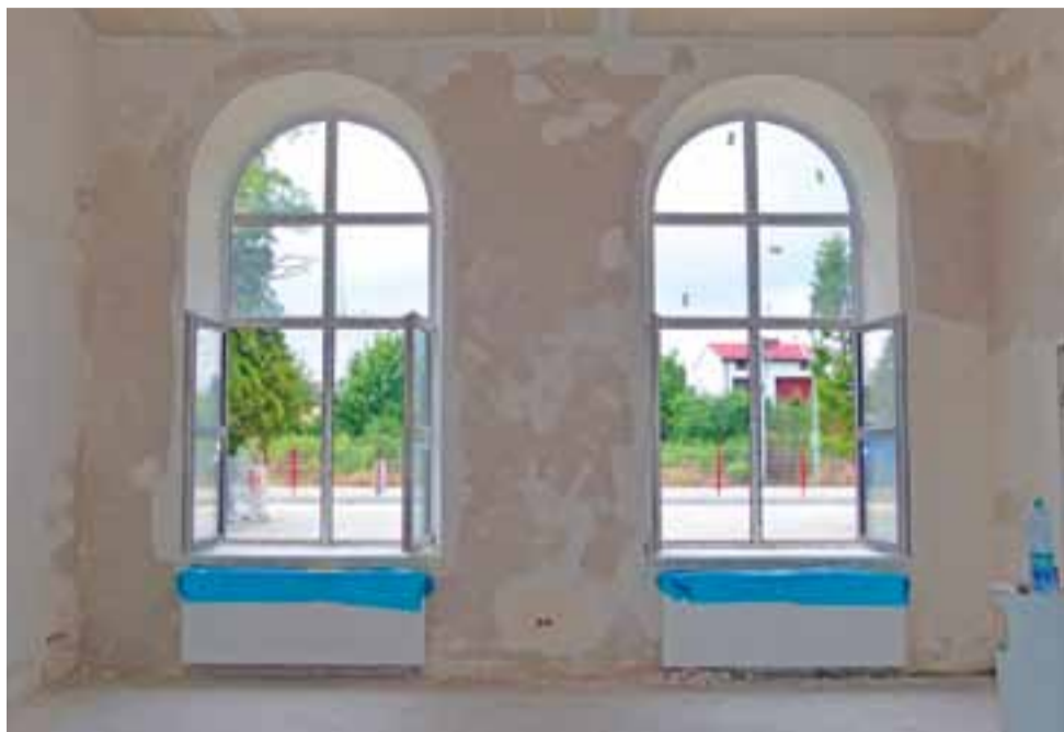
Tynki nie schną. Budynek długo był nieużywany, wilgoć w murach nadal jest bardzo duża, a to opóźnia prace wykończeniowe we wnętrzu.
