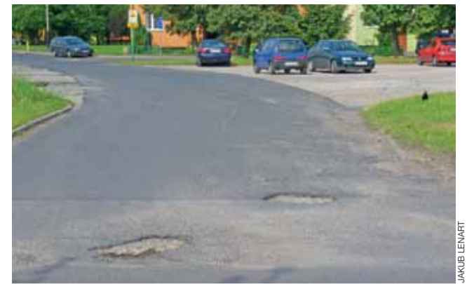
Dziury na jeździe na parking przeszkadzają kierowcom.
