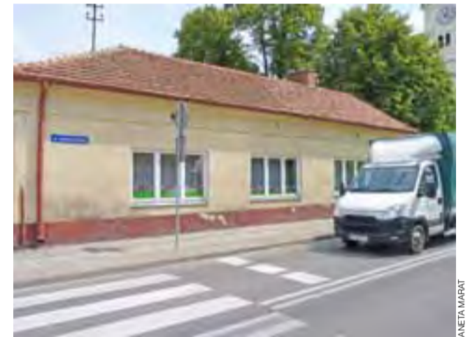
Przedszkole w Bolimowie wymaga gruntownego remontu, zmiana dachu jest jednak na razie priorytetem.
