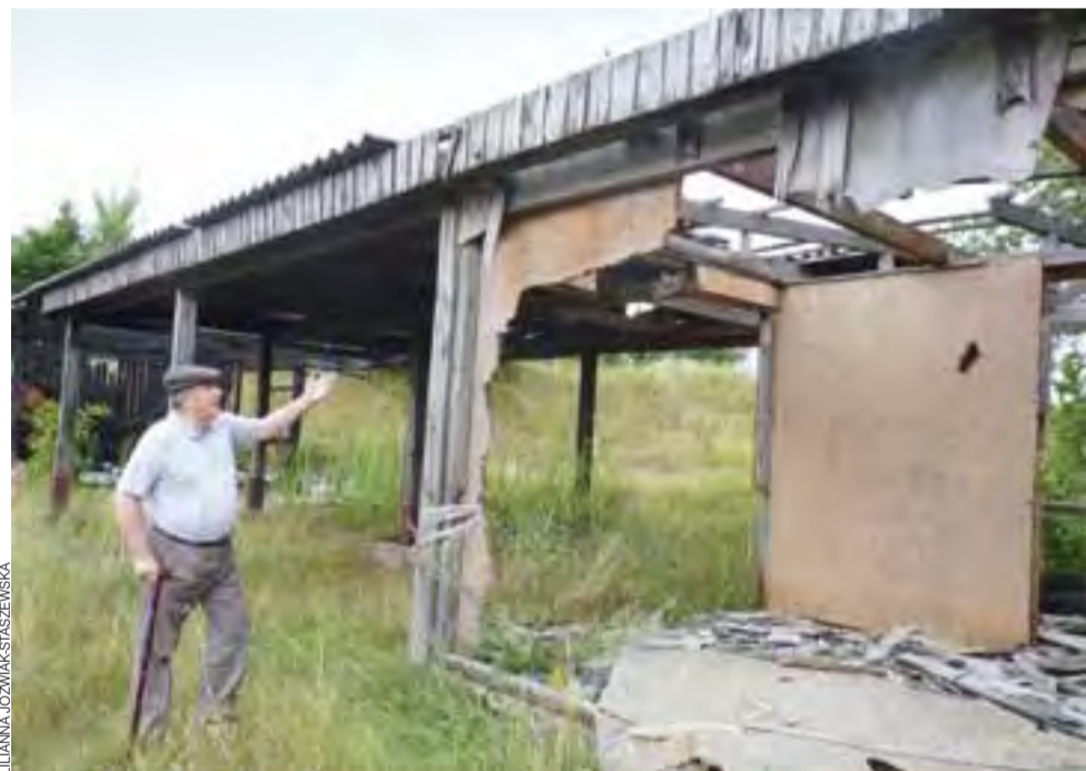
Jan Jędrzejczak pokazuje resztki konstrukcji dachu, na którą lubią wchodzić dzieci.
