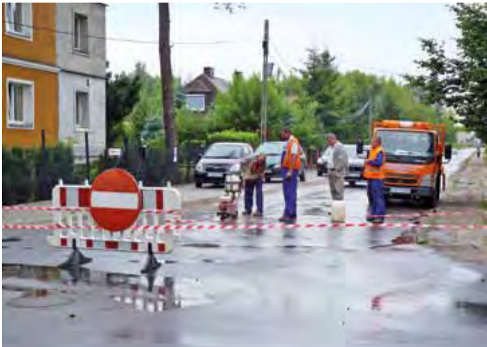
Czackiego nie przejeździemy. Początek budowy kanalizacji sanitarnej od strony skrzyżowania z Wojska Polskiego.
