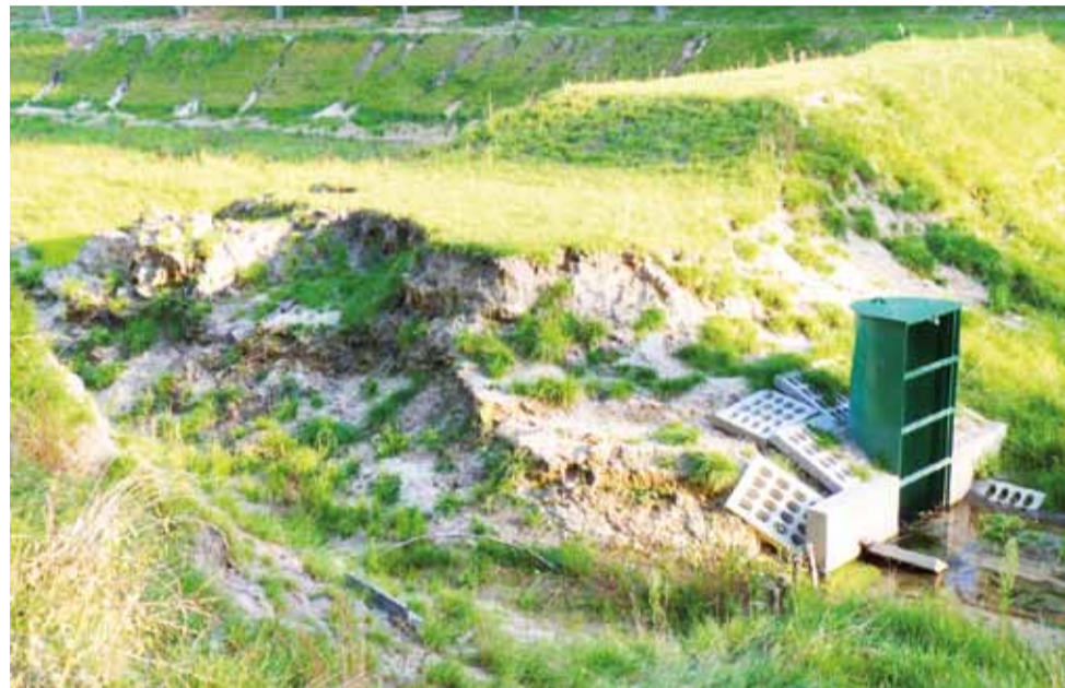
Czerwcowe oberwania chmur zniszczyły konstrukcję wału ograniczającego segmenty zbiornika, ale – jak zapewnia nadleśnictwo – oszczędziły mnichy, czyli urządzenia spiętrzające.
