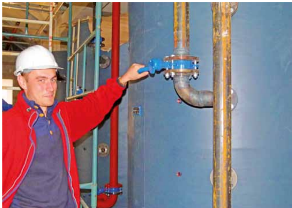
Łukasz Kopacz z Eco-Thermu koordynuje inwestycję w Dobieszkowie. Na zdjęciu przy zbiornikach buforowych zamontowanych w nowo wybudowanej kotłowni.
