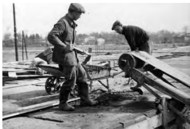
Zalanie stropów obecnego budynku szkoły.
