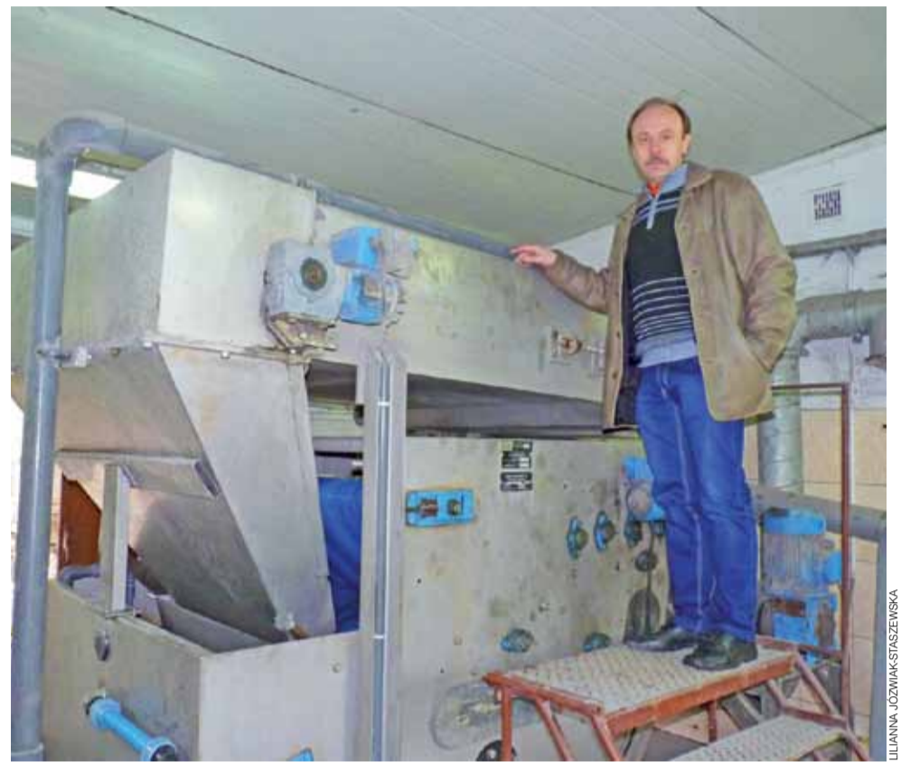
Kierownik Grzegorz Miśkiewicz w budynku strykowski oczyszczalni.
