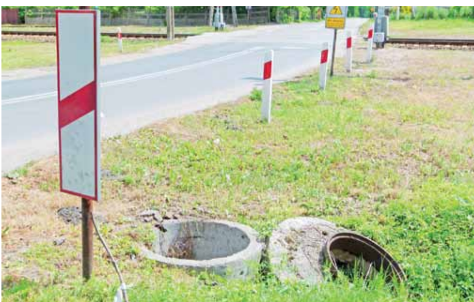
Tu groziło niebezpieczeństwo. Niezabezpieczona studzienka przy Zabrzeźniańskiej, stan na 17 czerwca.
