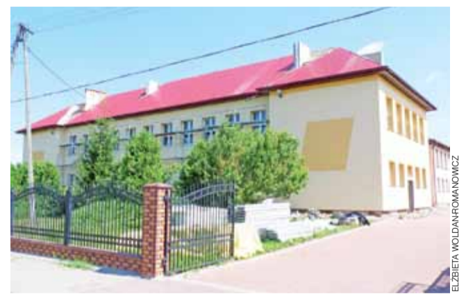
Remont od frontu. Tutaj nowy dach na budynku szkoły w Mąkolicach już widać, stan na 14 lipca.
