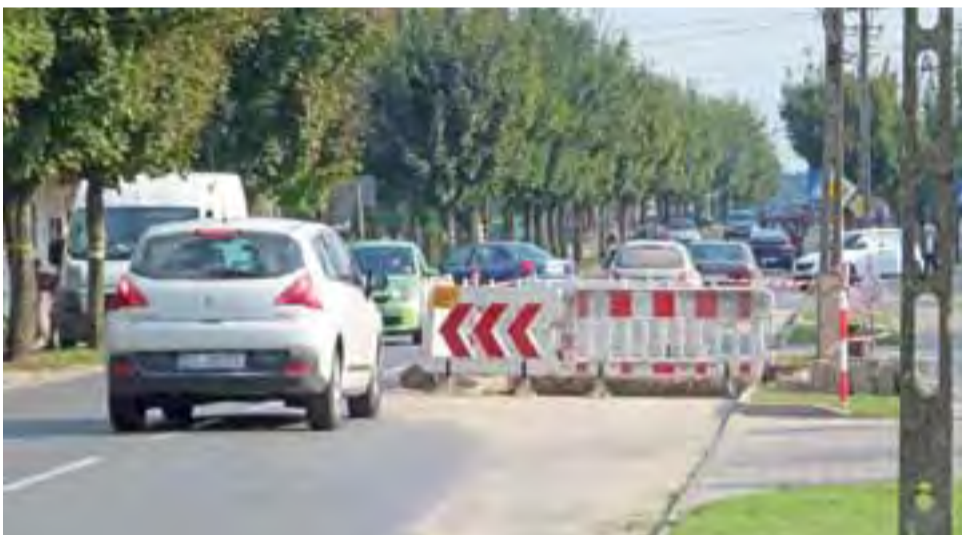
Awaria wodociągowa na Sikorskiego spowodowała nie tylko przerwę w dostawie wody, ale i utrudnienia w ruchu pojazdów. Stan na 18 września.
