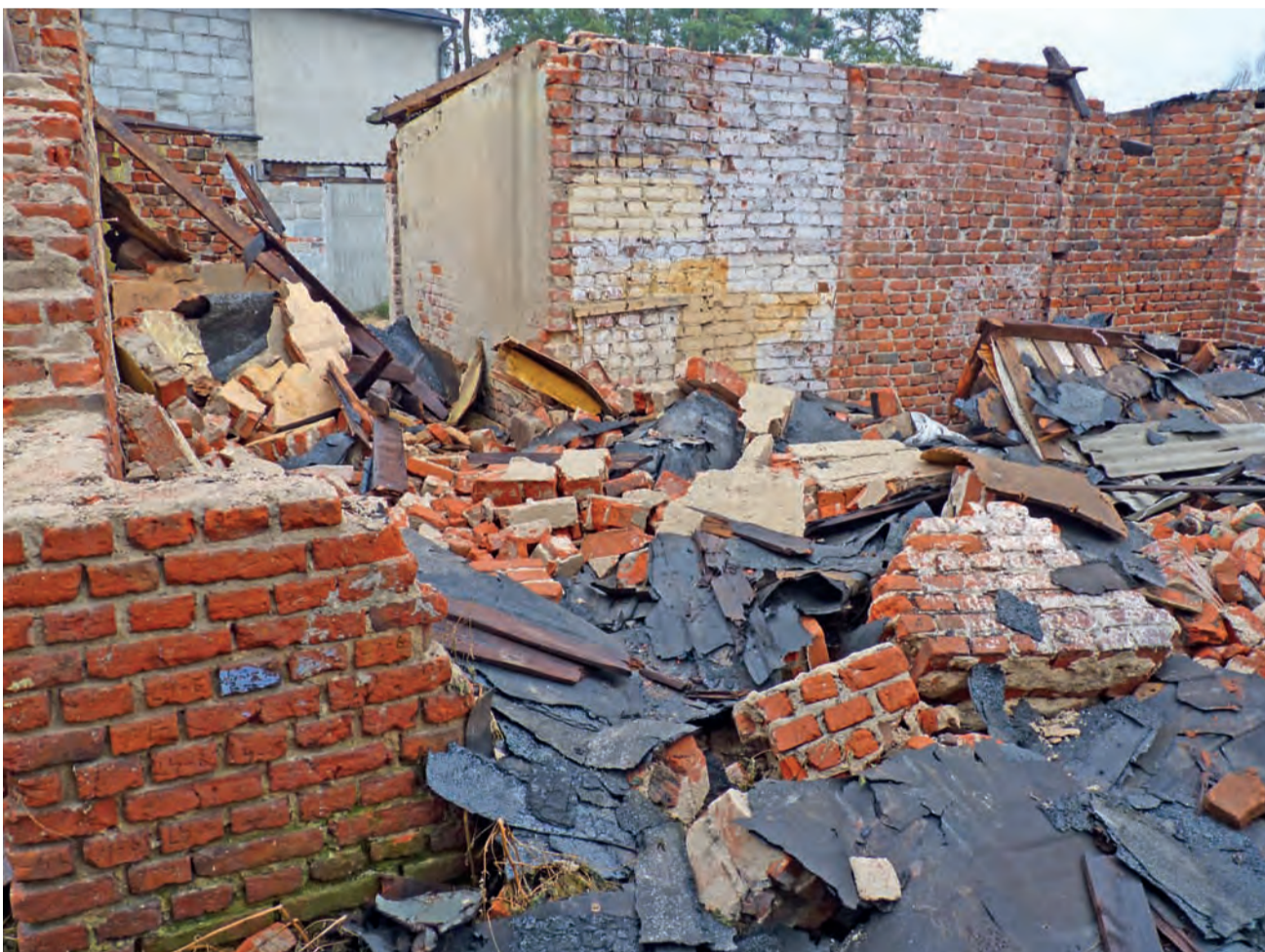
Zaproszenie ognia na ul. Zagajnikowej. Do pożaru doszło 30 grudnia około godz. 21 w starym pomieszczeniu gospodarczym przy ul. Zagajnikowej 8/10 w Głownie. Jego przyczyną było prawdopodobnie nieumyślne zaproszenie ognia przez osoby nieznanne. Spaliła się część dachu budynku Miejskiego Zakładu Komunalnego, który już jakiś czas temu przeznaczony został do rozbioru. W wyniku pożaru przewróciła się jedna z zewnętrznych ścian starego budynku. Strażacy dokładnie przeszukali pogorzelisko. W budynku nie znajdowały się żadne osoby, choć podejrzewano, że mógł tam przebywać ktoś bezdomny. pw
