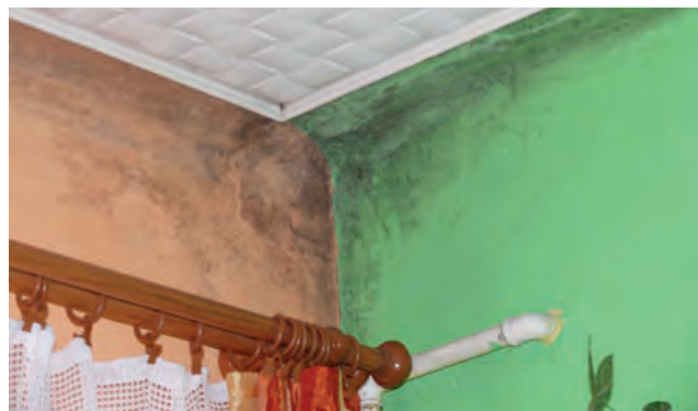
W mieszkaniu na piętrze czarny nalot pleśni na ścianach i suficie jest bardzo wyraźny.
