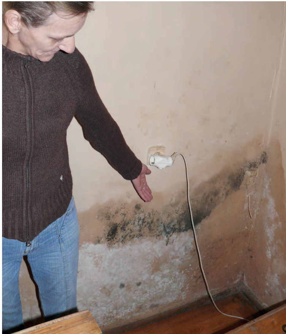
Pani Ewa, jedna z mieszkanek bloku 43i, pokazuje wilgoć i pleśń na ścianach swego lokalu.
