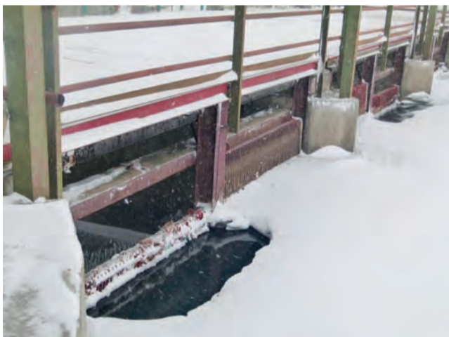
Napływ wody do jazu utrudnia już gruba warstwa lodu. Zastąpienie zastawek spowodowało wzmocniony napór wody na konstrukcję obiektu.
