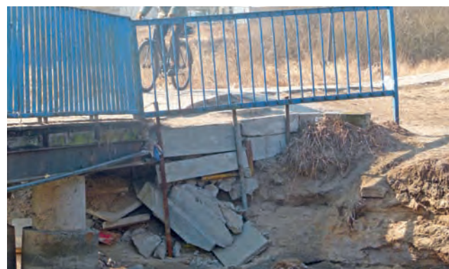
Stan przyczółka od strony osiedla Sikorskiego może niepokoić.
