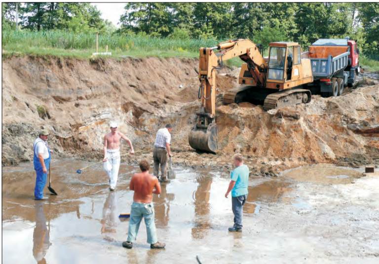
Po ostatnich ulewach wody gruntowe zalały betonową płytę wykonaną pod zbiorniki oczyszczalni ścieków.
