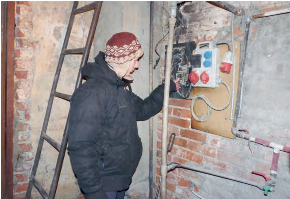
Mateusz Krukar pokazuje, że pożar zaczął się od zwarcia instalacji w kotłowni.
