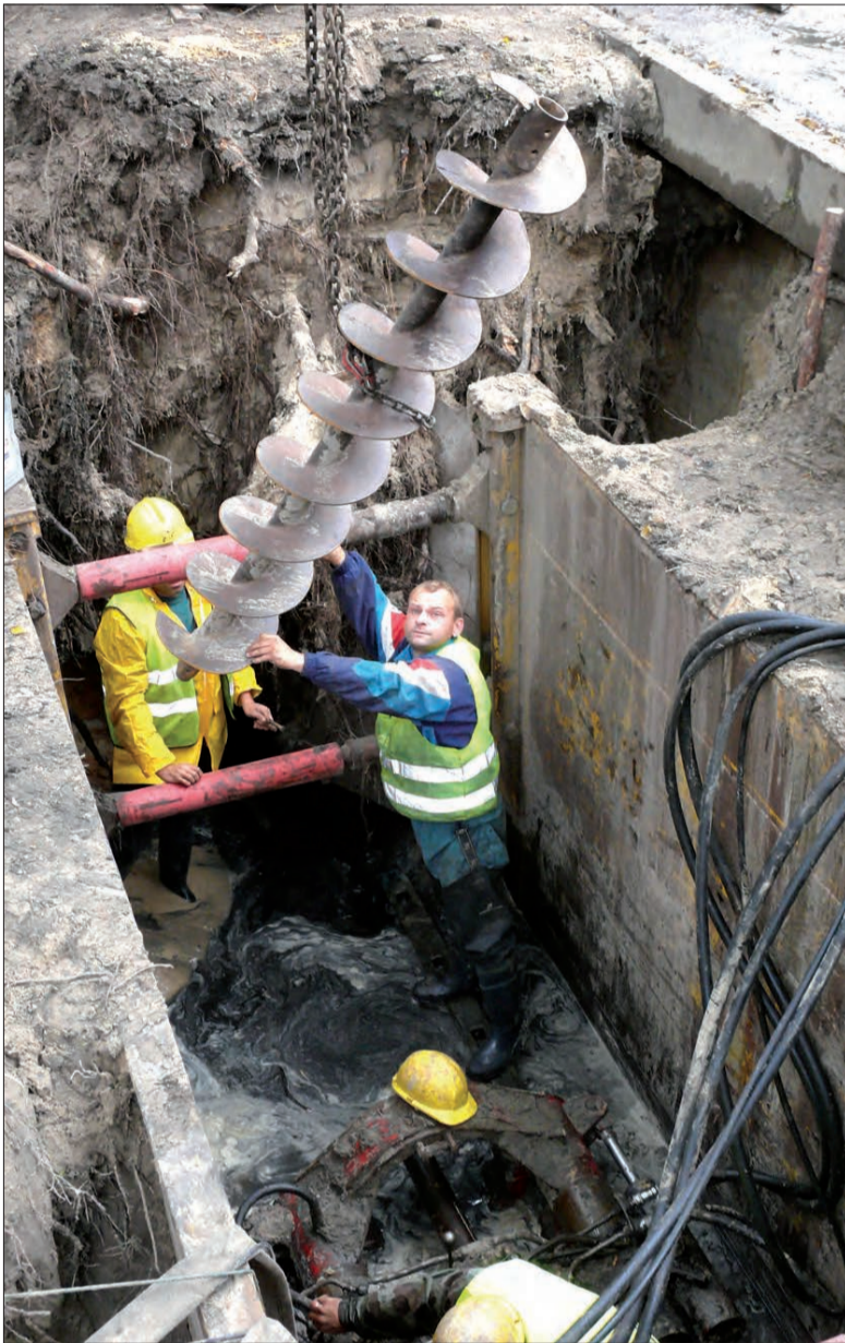
Do rozwiercania kanału wykorzystywane były świdy o dużych średnicach, na zdjęciu jeden z nich przed montażem w urządzeniu wprowadzającym w kanał.
