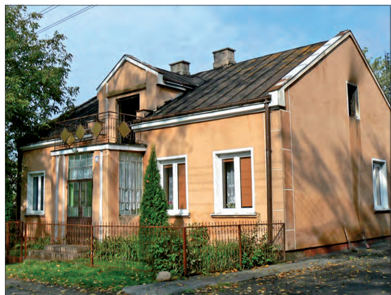
Całe poddasze tego domu w Boczkach spaliło się w pożarze. Jeszcze przed zimą trzeba wymienić nadpaloną konstrukcję dachu i jego poszycie.
