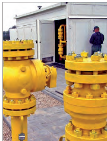
Stacja redukcyjna gazu w Zielkowicach.
