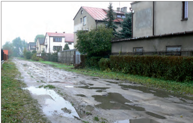
Tak po ostatnich opadach deszczu wygląda ul. Lniana na Przedmieściu.
