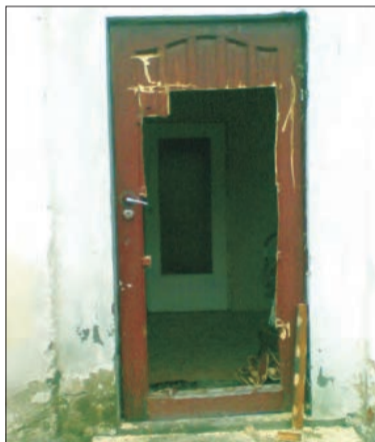
Tak wyglądały drzwi wejściowe zniszczone piłą spalinową.
