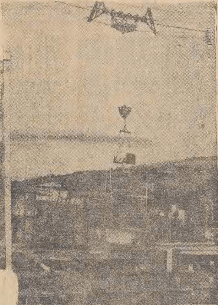
Roźnów Nr. 1 nie wystarczy dla naszych potrzeb elektryfikacyjnych i „ambicji energetycznych”: w Czechowie (województwo krakowskie) buduje się zapórę wodną drugą pod względem wielkości w Polsce. Otwarcie jej przewiduje się już na r. 1948.
