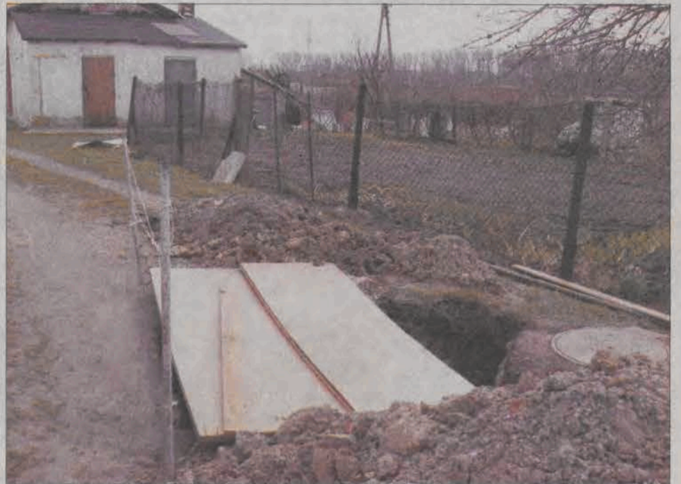
Przez trzy tygodnie wykop przy budynku nr 11 na ul. Blich był zabezpieczony w taki sposób.
