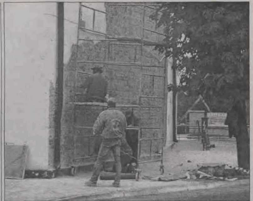
Tynk już nie będzie odpadał. Pracownicy jednej ze strykowskich firm budowlanych zmieniają otynkowanie na jednej ze ścian strykowskiego Ośrodka Kultury. Stary, odpadający tynk zostanie usunięty i zastąpiony nowym, a budynek w samym centrum miasta zyska na wyglądzie. (ljs)
