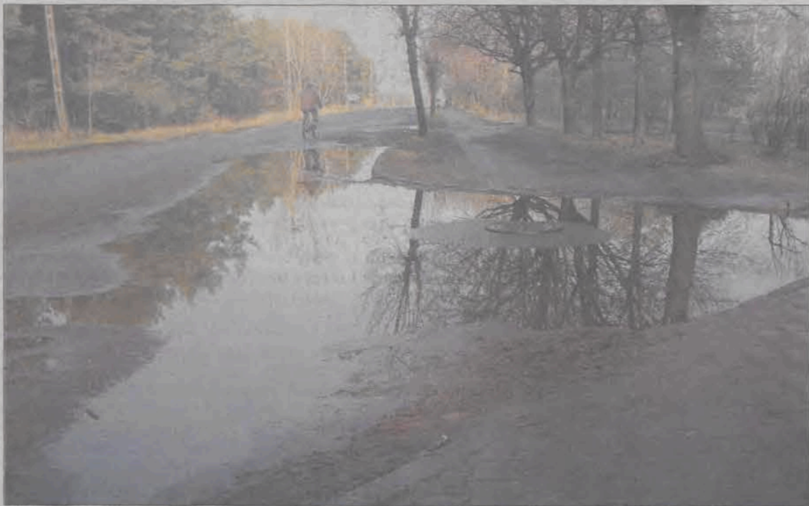
Sikorskiego jak staw. Wystarczy mały deszcz, by ulica Sikorskiego w Głownie przy wyjeździe ze starego osiedla mieszkaniowego zamieniała się w staw. Stojąca po kostki woda i zgnite liście zalegające przy krawężnikach od tygodni skutecznie utrudniają życie przechodniom idącym chodnikiem i kierowcom, którzy wjeżdżają albo wyjeżdżają z osiedla. (ljs)
