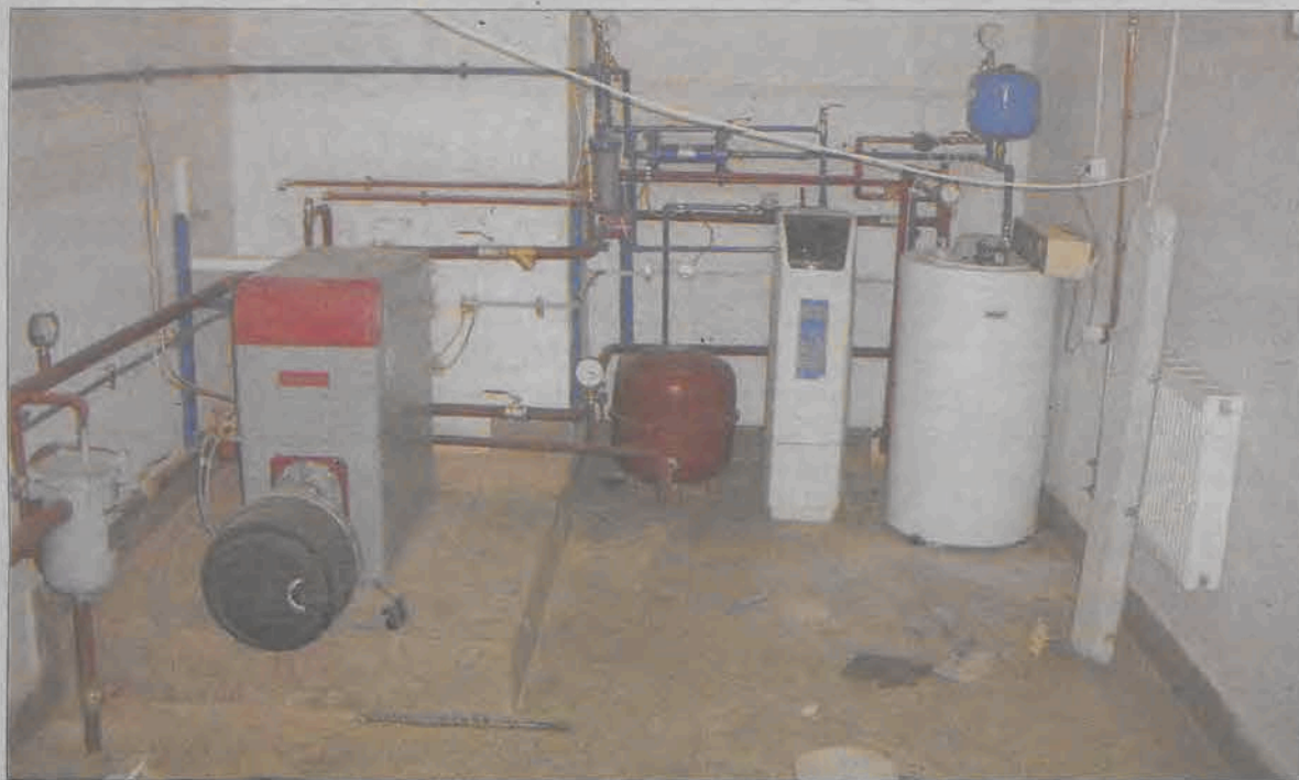
Szkoła w Waliszewie od kilku tygodni ogrzewana jest ciepłem z nowej kotłowni.
