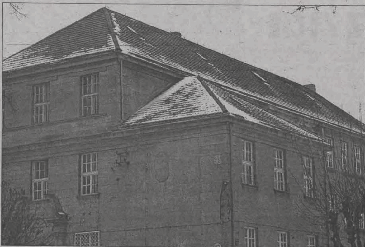
Na wierzchu ładny, a pod spodem ... to już inne zmartwienie.
