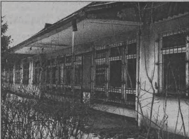
Gołym okiem widać, że potrzebny jest solidny remont.
