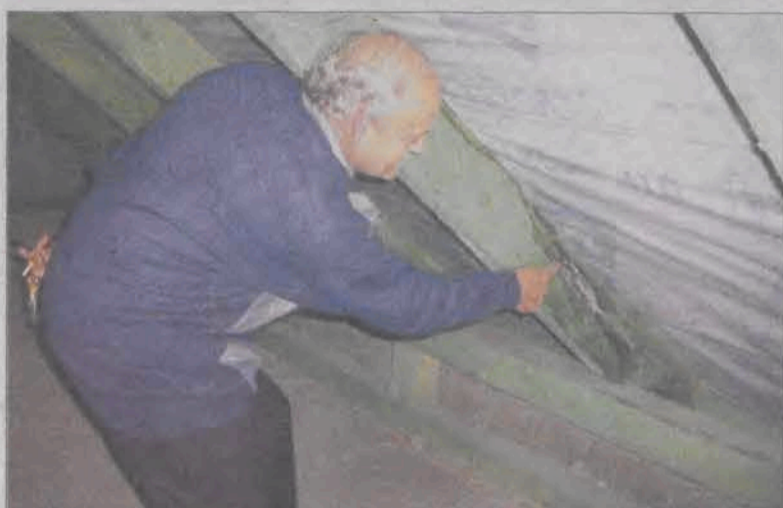
Wykonawca dachu na głównym budynku „Jedynki” - łódzka firma Dach - Marczuk, powinien poprawić wiele niedociągnięć, jak choćby tę przemakającą deskę na stropie - demonstruje wicedyrektor SP1 Janusz Lewandowski.
