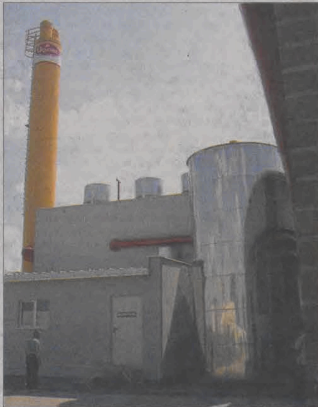
Nowo powstała kotłownia w firmie Bracia Urbanek powstała również przy udziale środków SAPARD.
