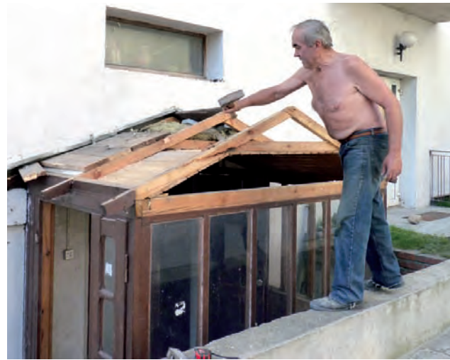
Dotychczasowy drewniany ganek był już bardzo zniszczony.
