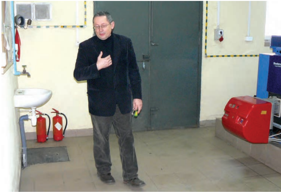
W kotłowni szkoły dyr. Wacław Witwicki. Po lewej stronie w posadzce widoczna kratka, przez którą wydostaje się szambo.
