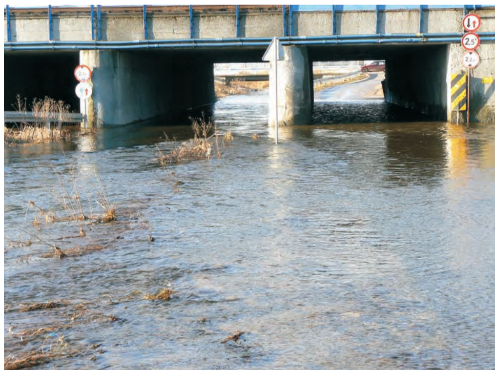
Tunel pod torami w ciągu ul. Arkadyjskiej był nieprzejezdny.
