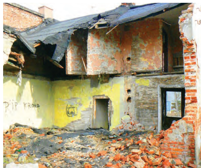
Zarządca tej rozpadającej rudery ma rozpocząć jej rozbiórkę w ciągu 6 tygodni od wydania decyzji PINB i zakończyć ją w ciągu kolejnych dwóch miesięcy.
