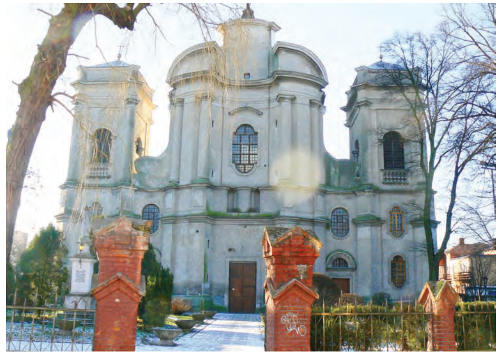
Kościół pijarski. Remont wewnątrz wież czy wymiana okien są równie konieczne co remont fasady.
