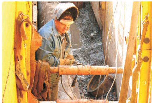
Przeciski pod ul. Bolimowską wykonywano na dyżych głębokościach, potrzebne był stalowy szalunek, by opanować niestabilny grunt.
