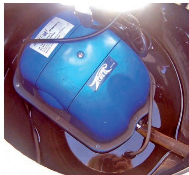
Elektryczna sprężarka zanurzona w wodzie.
