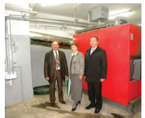
Zmodernizowana kotłownia na paliwo stałe eko-groszek.
