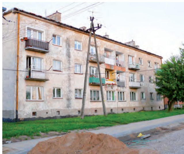
Blok nr 17 na os. Kostka w Łowiczu – jeden z niewielu bloków czekających na tym osiedlu na docieplenie i poprawę estetyki elewacji, która po prostu się sypie.
