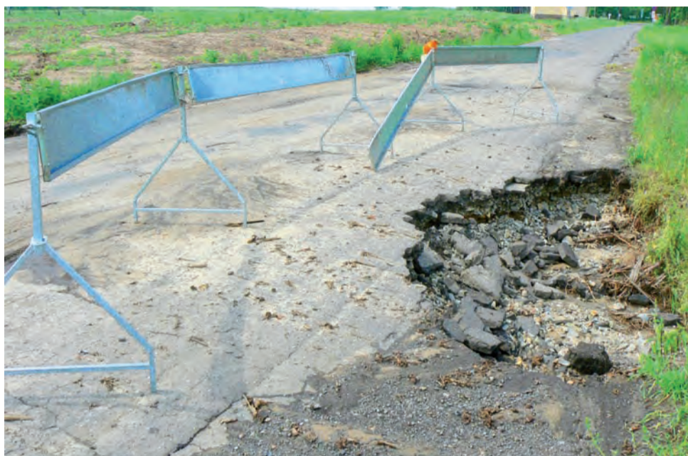
Niszczycielska jest siła wody. Wyrwa na drodze z Dmosina do Grodziska.
