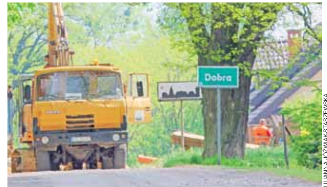
Największe nagromadzenie robót póki co w okolicach Dobrej. Tutaj remontowane są nie tylko drogi, ale również budowana jest kanalizacja.
