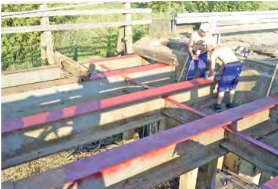
Przeście z rowerem po stalowych dźwigarach, które pozostają po rozebraniu nawierzchni, nie jest bezpieczne.
