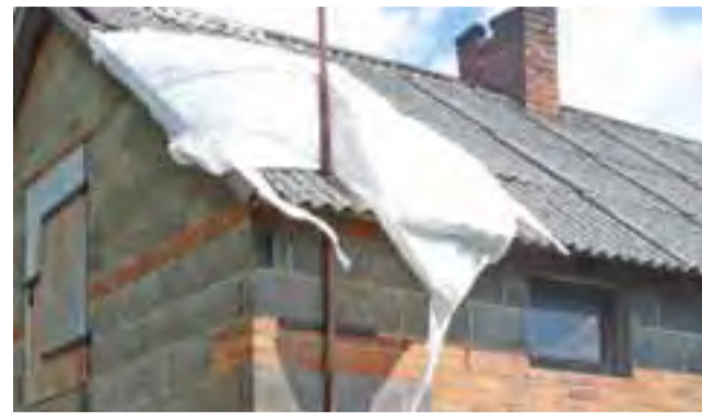
Eternitowe dachy wciąż nie należą do rzadkości. Tutaj – dach zniszczony na domu w Borówku podczas lipcowej nawałnicy.
