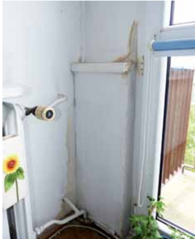
W jednym z mieszkań na IV piętrze powstały zacieki na ścianach w dwóch pokojach. Podobnie jest w innych lokalach.
