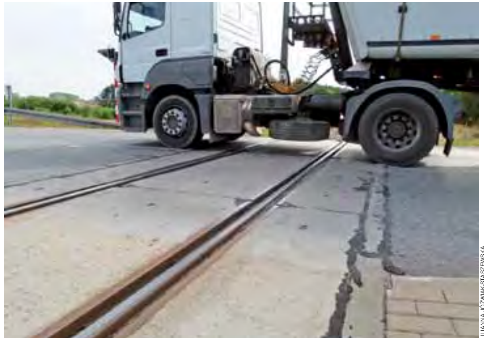
Mieszkańcy chcą, aby kolej od nowa wyremontowała emitujący hałas przejazd w Smolicach.
