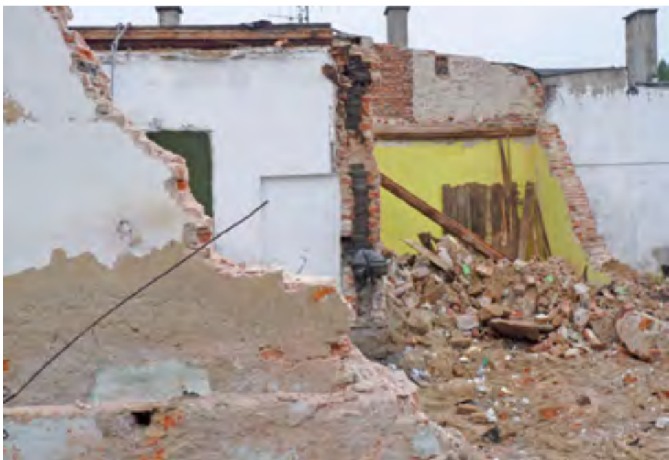
Budynek zniknął cegła po cegle, pozostawiając pustą przestrzeń w narożniku ulicy Kolejowej.
