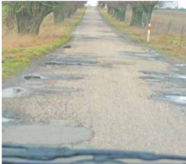
Droga powiatowa ze Śleszyna w stronę Balikowa też jest w wielu miejscach bardzo zniszczona i wymaga kompleksowego remontu
