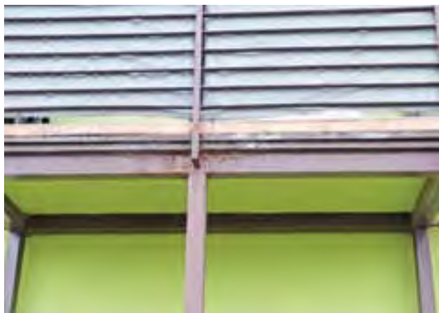
Korozja konstrukcji balkonów to tylko drobna część zastrzeżeń, jakie można mieć do ich technicznego stanu. Gorsze jest to, że do niej wewnątrz dostaje się woda.
