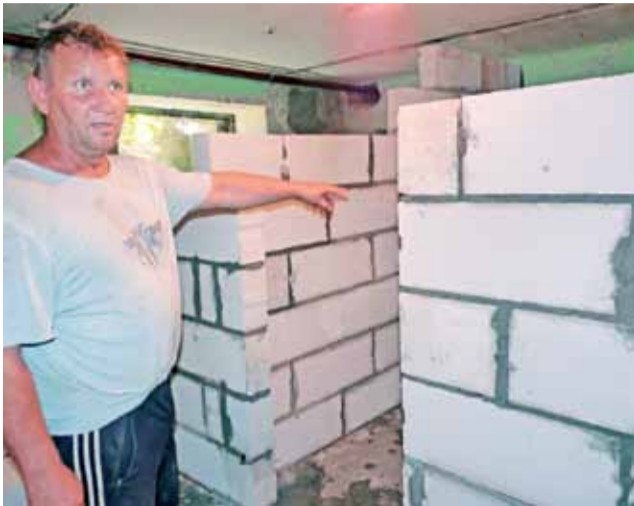
Prace przy adaptacji schronu oraz pomieszczeń po dawnych pralniach wykonują pracownicy spółdzielni.
