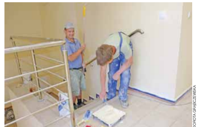
W budynku dawnego kina Lech trwają ostatnie prace wykończeniowe przy modernizacji części administracyjnej.
