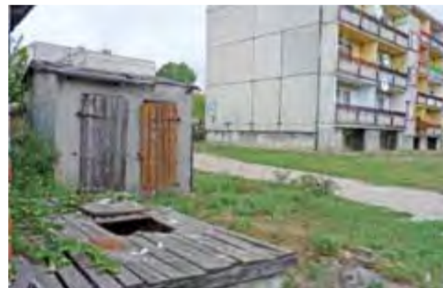
Fetor z otwartej kloaki w centrum miasta, przy Narutowicza 55 i 53, utrudnia od lat normalne funkcjonowanie mieszkańcom pobliskich bloków.
