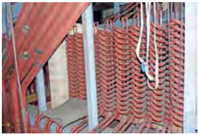
Serce kotła czyli system rur, w których podgrzewana jest woda.
