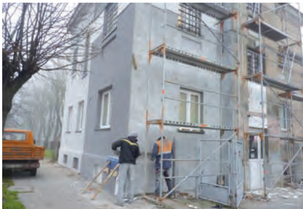
Pracownicy z firmy Elvis z Żychlina robią nową elewację budynku Komisariatu Policji w Żychlinie. Zdemontowano dwa balkony znajdujące się nad wejściem.
