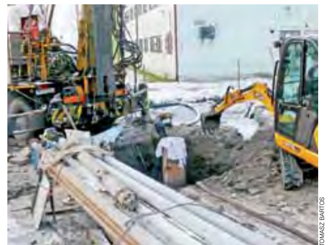
Ostatnie prace przy studni głębinowej w Mysłakowie. Firmie realizującej zlecenie pozostało tylko uzbroić otwór w pompę i wszystkie instalacje.
