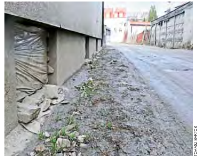
Obecnie, aby wjechać na ul. Wegnera i Rotstada, trzeba pokonywać po deszczu głębokie kałuże, błoto z nich chlapie na elewacje sąsiadujących z ulicą budynków.
