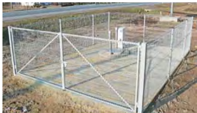
Jedna z dwóch przepompowni wykonanych w ramach zakończonej inwestycji znajduje się przy ul. Makowiska.
