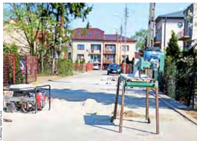
Trwają ostatnie prace przy budowie nawierzchni ul. Działowej, obecnie jest ona uzupełniana docinaną kostką.
