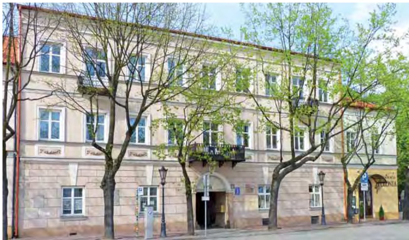
Od Starego Rynku kamienica napoleońska wygląda bardzo okazale, jej elewacja ma wprawdzie niewielkie pęknięcia, ale poza nimi nic nie wskazuje na to, w jak złym jest stanie technicznym.
